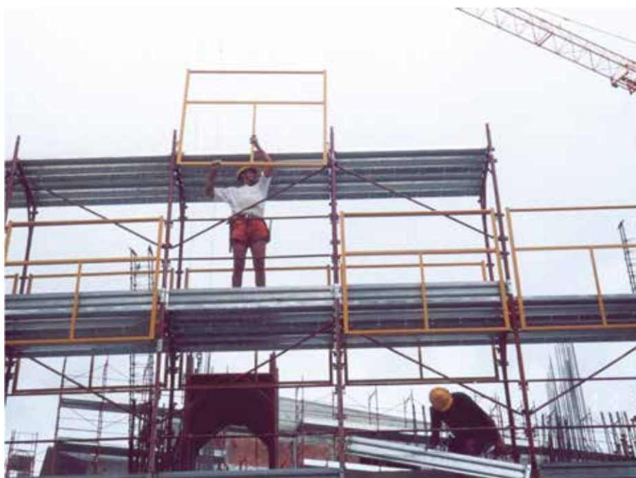
Foto 2. Montaggio del ponteggio a telai prefabbricati in sicurezza con parapetto provvisorio dal di sotto.
