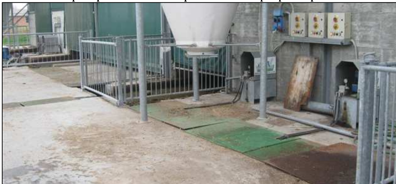
Esempio di pedana carrabile di copertura canalette e parapetto di protezione
